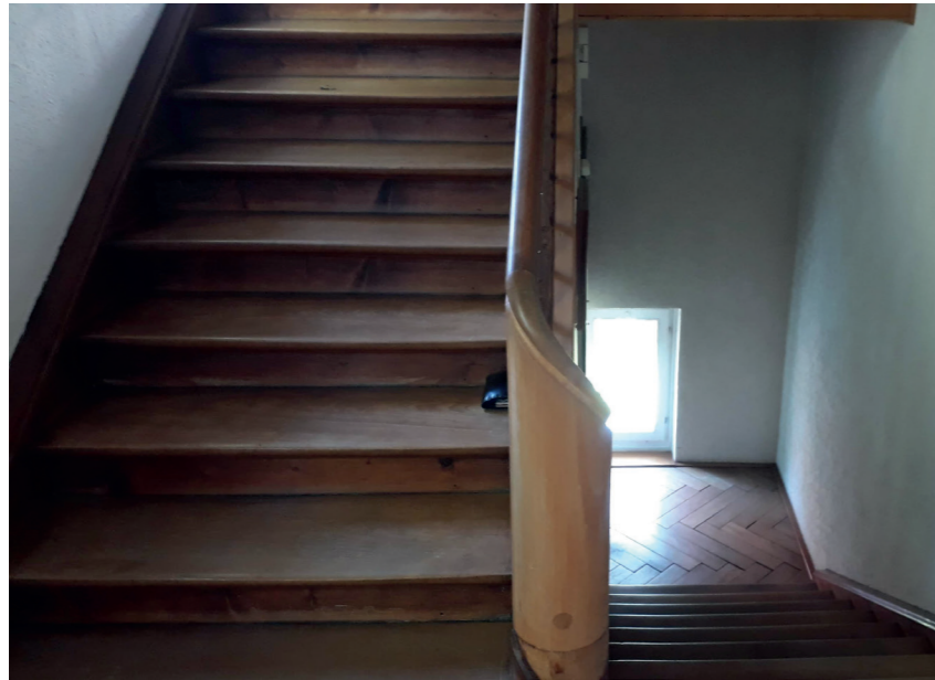
Die wertige alte Holztreppe konnte vor Ort wiederverwendet werden: Die massiven Tritte wurden gehobelt und als Schwellen im Innen- und Aussenbereich eingesetzt
