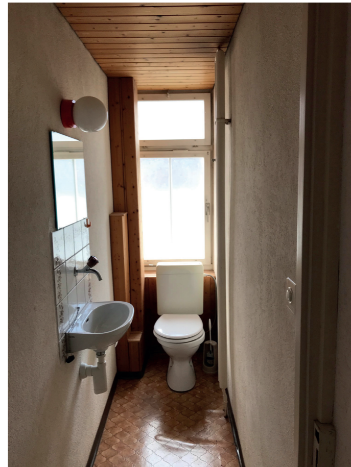
Die Fensteröffnungen der schmalen Toiletten wurden zu Eingangstüren vergrössert. Die Spuren des ehemaligen Bads sind an Boden und Decke weiter sichtbar.
