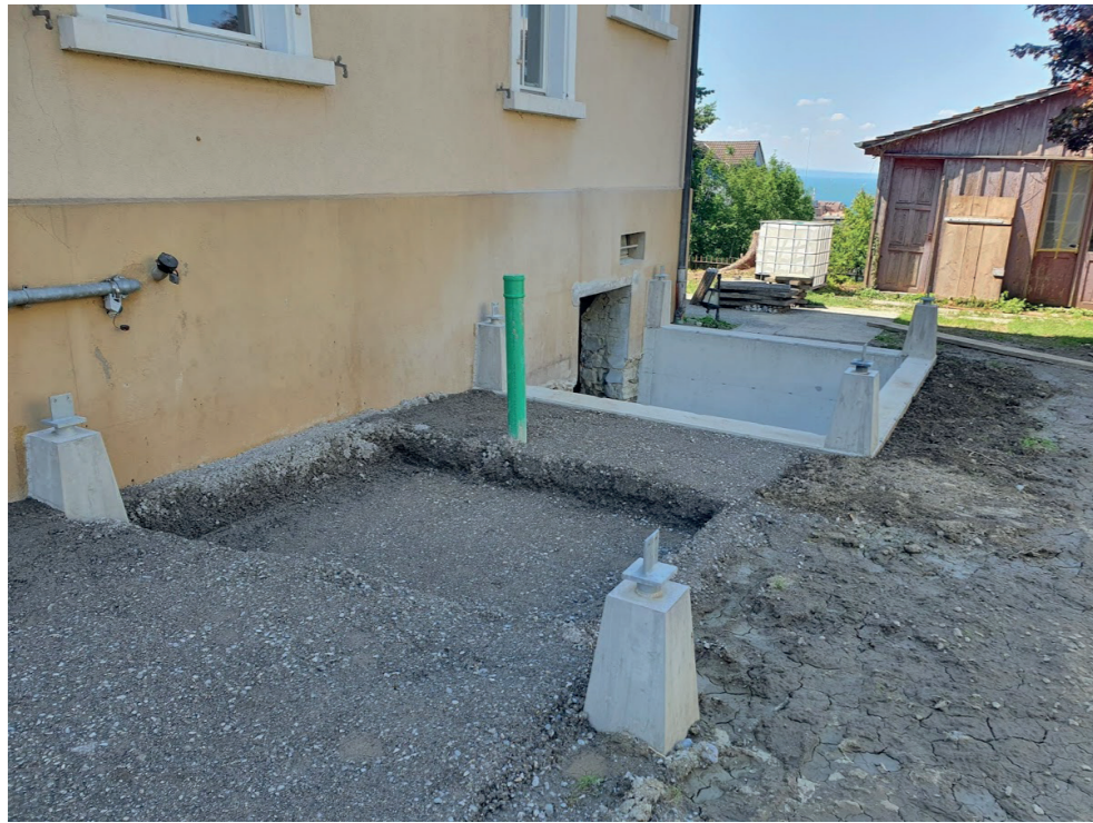
Als Erstes wurde die Holzlaube gestellt, diese diente dann als Baugerüst für die weiteren Arbeiten.
